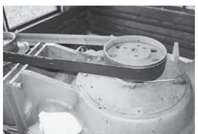
利平茶屋の発電機ベルトン水車型小水力発電機。最大出力が22kwで大きな水量を要しない。
