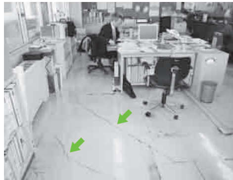
▲床に亀裂が走り、耐震工事が急がれる役場庁舎
