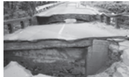
▲ 崩落した大井沢佐土橋
