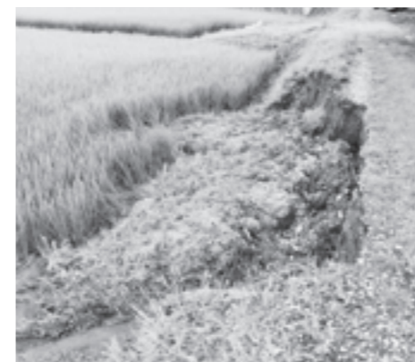
▲農道が崩落した水田
