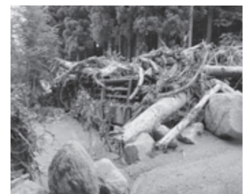
▲土砂と流木にうもれた大井戸沢橋 (大井沢)
