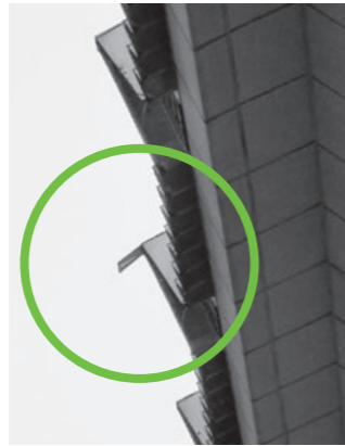
▲トタンの一部が落下しそうな屋根
