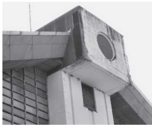
▲はがれ落ちている壁面
