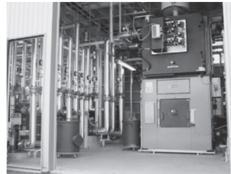
▲最上町の木質バイオマスボイラー
