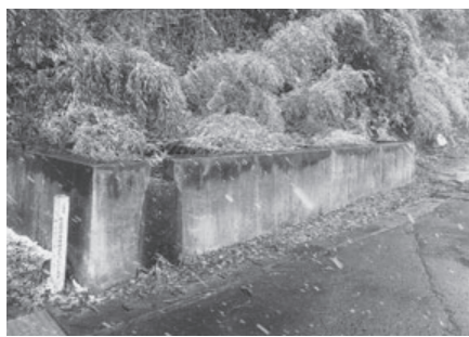
▲木が覆い被さっている無蓋貯水槽
