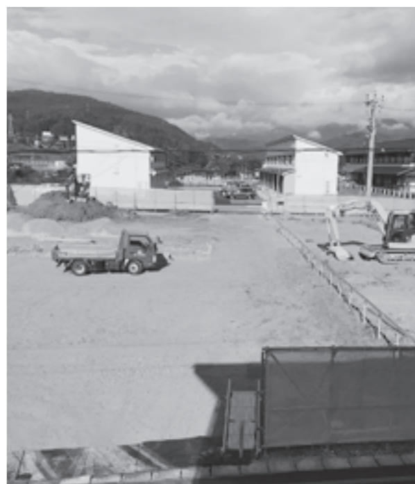
▲建設工事が始まった定住促進住宅(海味) ※後方の白い建物は若者定住促進住宅
