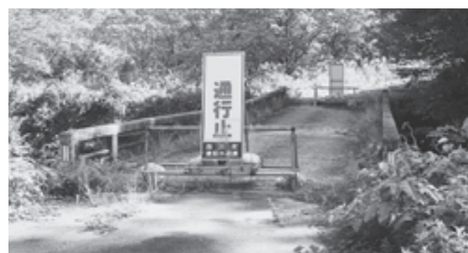
▶通行止めとなっている大入間川橋
