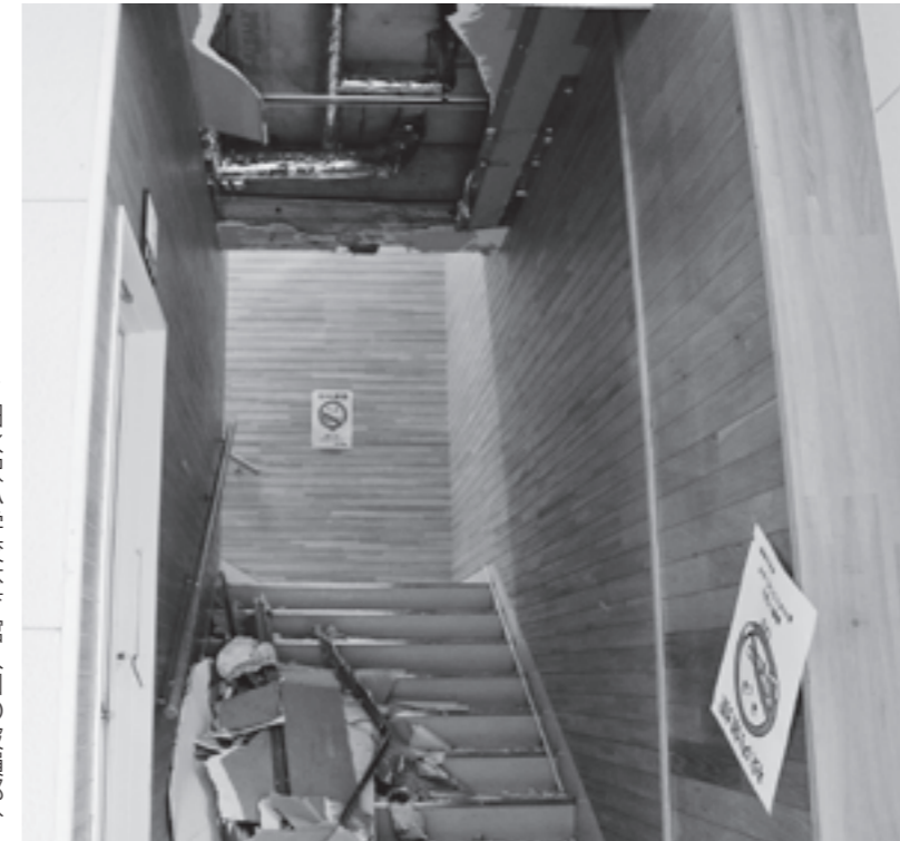
▶旧水沢小学校体育館入口の破損部分(天井が崩落し、配管が見えている)
