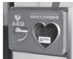
▲屋外に設置されているAED (大井沢温泉館)
