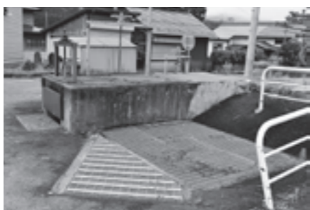
▶旧西山小学校下の水路に設置された柵と水門
