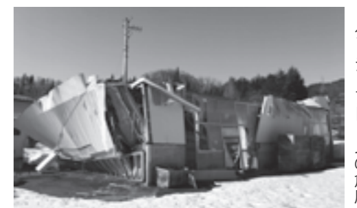
◀倒壊したケーシーフレームの倉庫
