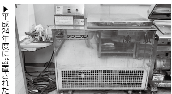
▶平成24年度に設置された急速冷凍機
