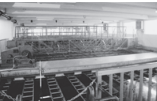
▶設備を増強した沈殿池
