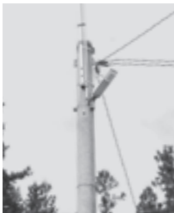
▲LED化された防犯灯
