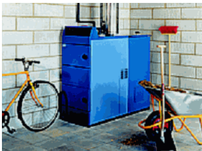
写真 7-5 ペレットボイラー
