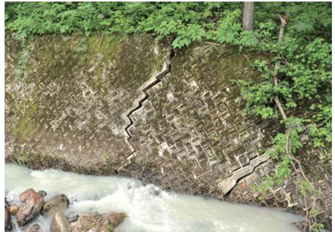
亀裂が入った志津「中沼沢川」の護岸ブロック
