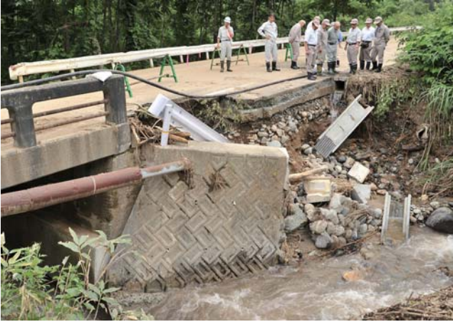
大井沢「県道 大江西川線」にかかる「佐土の沢橋」の状況
