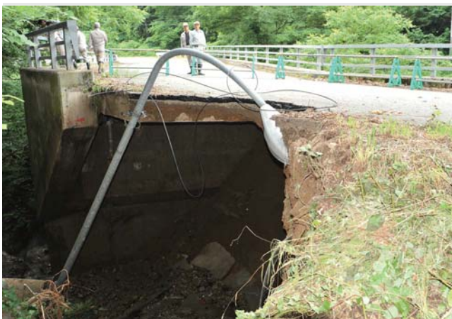
小山「やびつ橋」の橋台裏は抜け落ち危険な状態に
