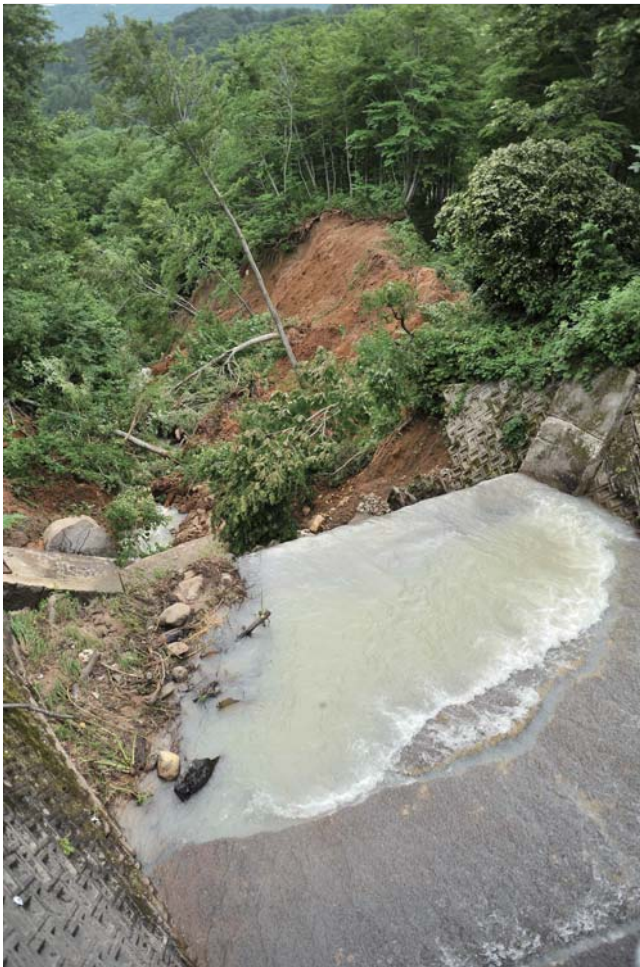
志津「中沼沢川」河床の亀裂は広がり、先の両岸は崩落が進む
