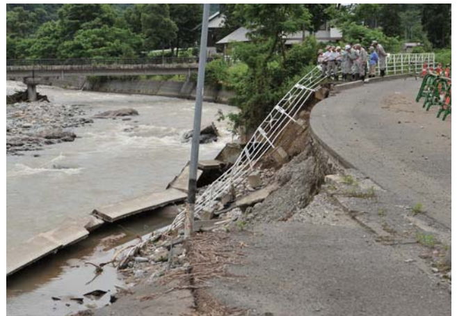
河川の氾濫によって県道が崩落した大井沢黒淵地内
